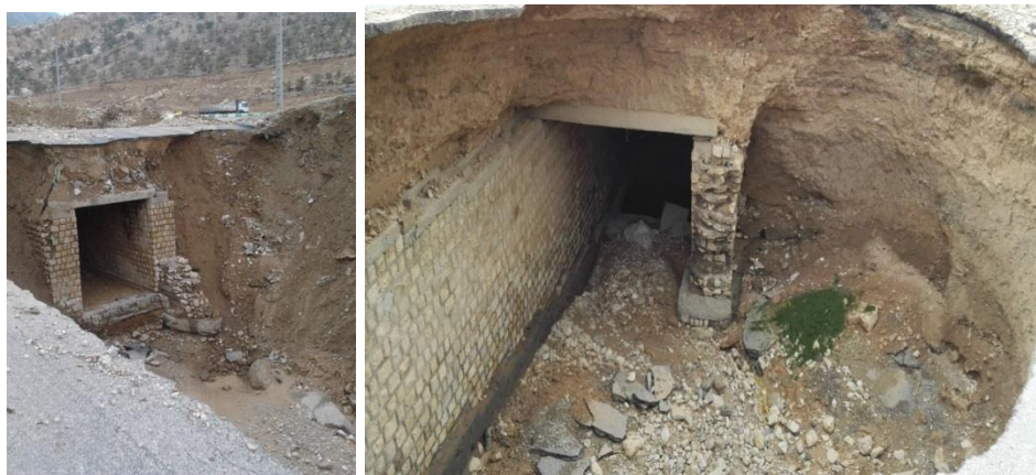
تصویر ۷ طراحی نامناسب شیب شکن، فرسایش بستر، واژگونی دیوار و چرخش آب درون گودال (بلوار ارغوان-ورودی)
