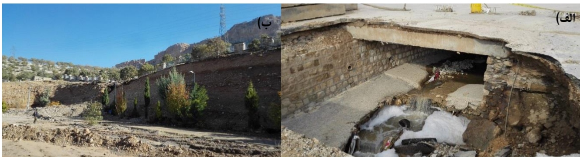
تصویر ۶ الف) جنس نامناسب دیواره عدم یکپارچگی دیواره -فرسایش پشت دیوار و وجود فاضلاب (بلوار هجرت) ب) فرسایش طبیعی و ورود واریزه‌ها به دلیل توپوگرافی منطقه (محل تصفیه‌خانه آب شرب شهر ایلام)
