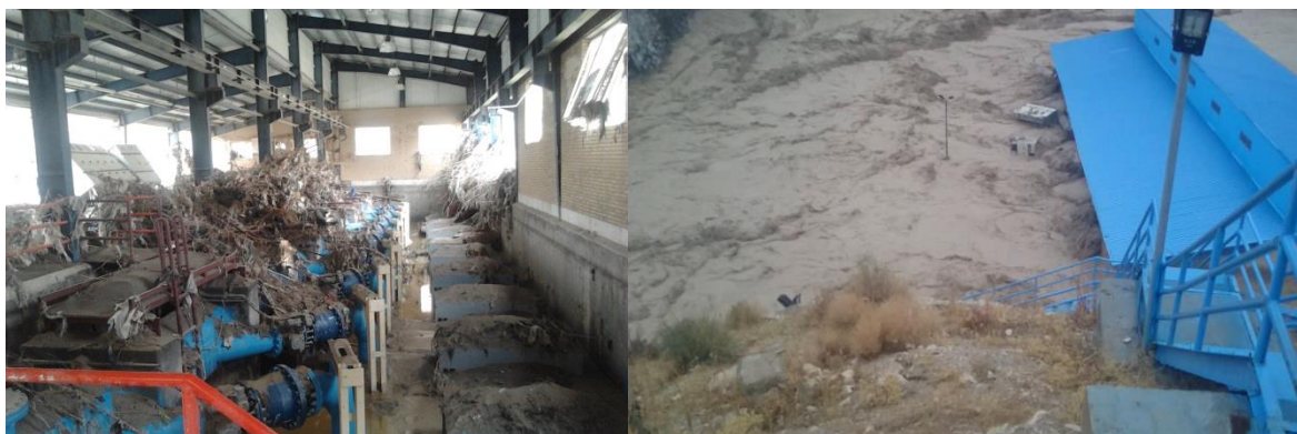
تصویر ۸ الف) وقوع سیلاب و تراز سیلاب مشاهداتی در ایستگاه پمپاژ رودخانه گدارخوش (۷ آبان ۱۳۹۴) ب) وضعیت خسارات واردشده به ایستگاه پمپاژ رودخانه گدارخوش (۱۹ آبان ۱۳۹۴)
